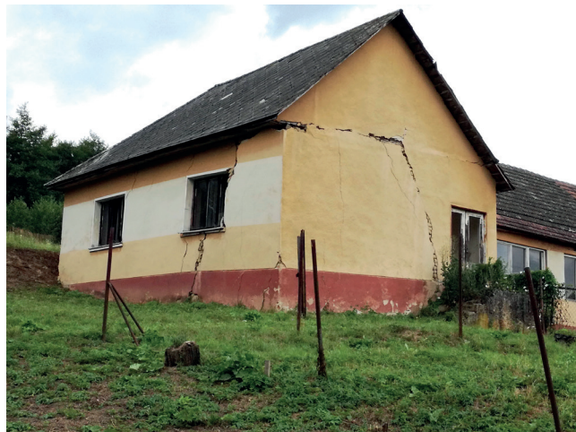
Obr. 9.1. Praskliny na dome postavenom na zosuve v Hornej Súči (foto P. Liščák).
