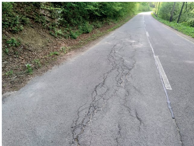
Obr. 9.2. Praskliny na vozovke na ceste v Hornej Súči-Záhradkách (foto P. Liščák).
