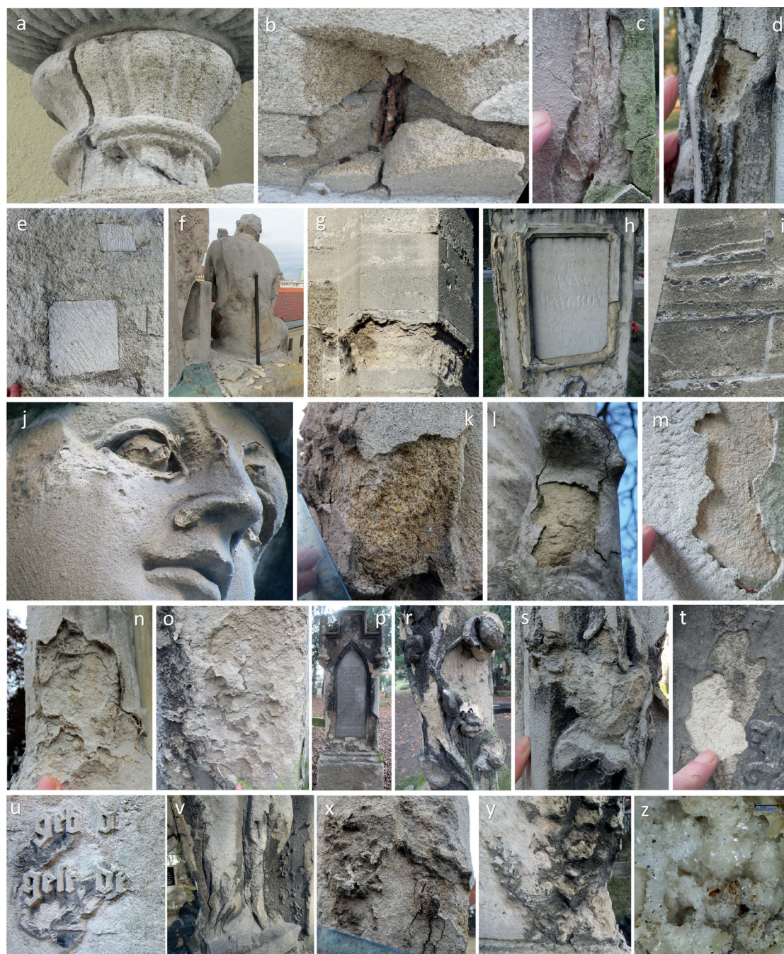
Obr. 9. Degradácia pórovitých vápencov pamiatok Bratislavy: a, b – praskliny v staticky namáhanom spoji; c – praskliny a úbytok hmoty; d – porušenie tvaru zväčšením objemu; e – kamenné záplaty poškodeného povrchu; f – opadávanie zvetraných kusov kameňa; g – úbytok hmoty v menej odolnom bloku; h – j – pľuzgierovité formy deštrukcie kameňa; k, l – odpadnutie hrubšej zvetranej vrstvy kameňa, pod ktorou vidno skutočnú farbu vápenca; m, n – odlupovanie tenkých vrstiev vápenca a svetlých kôr obohatených o sírany; o – u – odlupovanie tenkých svetlých a tmavých kôr; v – odlupovanie čiernych kôr zvetrávaním a výkvetmi síranov; x, y – nepravidelná zhlukovitá degradácia povrchu spojená výkvetmi síranov; z – výkveti síranov. Palác na Ventúrskej ulici v Bratislave (a), Stará radnica v Bratislave (b), cintorín Kozia brána v Bratislave (c, o – r, t, u), Mikulášsky cintorín v Bratislave (d, s, v), Primaciálny palác v Bratislave (e, f, k, x, z), veža františkánskeho kostola v Bratislave (g), cintorín v Bratislave-Devíne (h, y), Dóm sv. Martina v Bratislave (i), fontána na Františkánskom námestí v Bratislave (j), socha sv. Jozefa v Rusovciach (l), cintorín v Bratislave-Rači (m) a Ondrejský cintorín v Bratislave (n).
