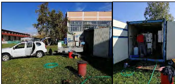
Obr. 4 Instalace technologie na lokalitě
