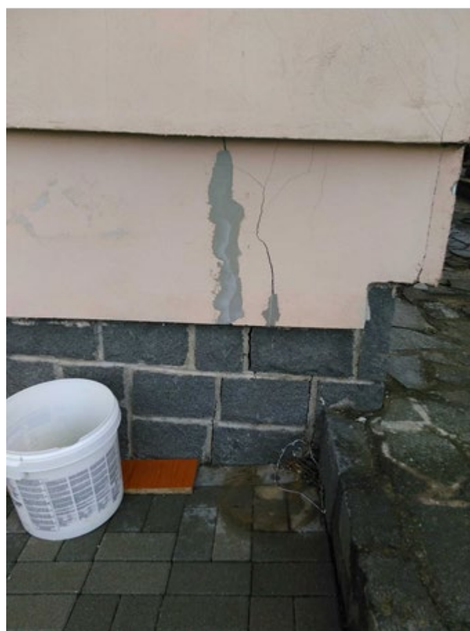
Aktívne svahové deformácie zdokumentované pri účelovom inžinierskogeologickom mapovaní na lokalite Ruská Nová Ves 2 - trhliny na múre rodinného domu č. 125
