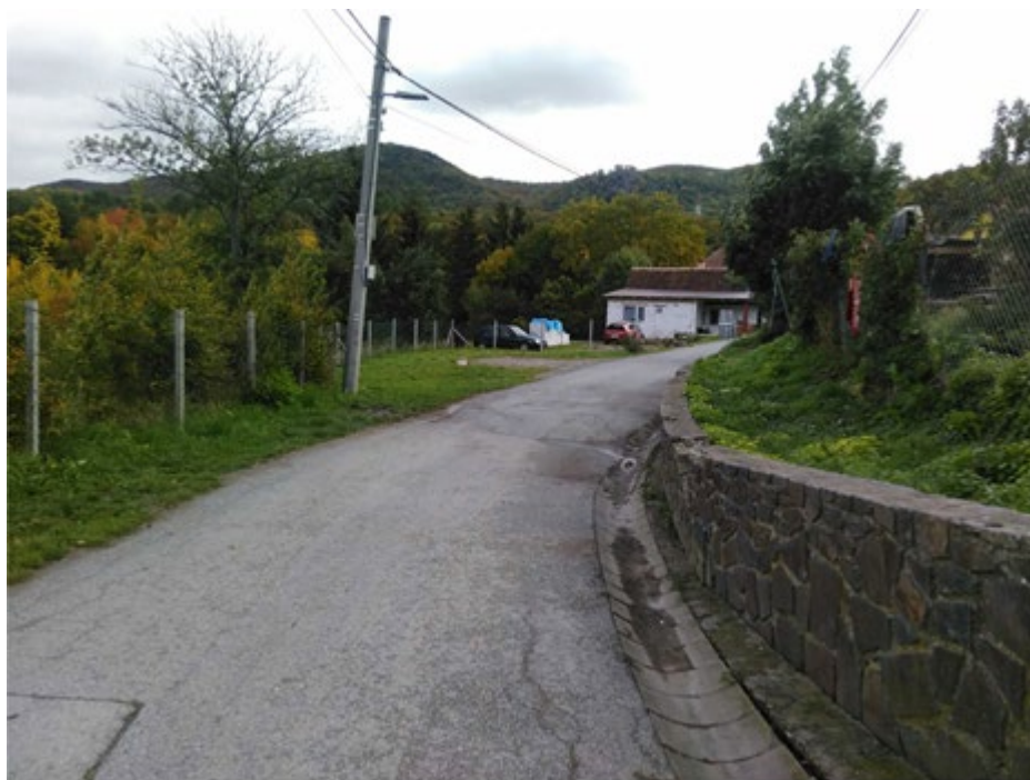
Aktívne svahové deformácie zdokumentované pri účelovom inžinierskogeologickom mapovaní na lokalite Ruská Nová Ves 2 v oblasti miestnej komunikácie pri rodinnom dome č. 130.
