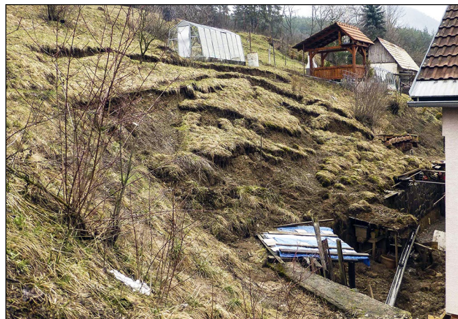
Obr. 1. Celkový pohľad na zosuv počas obhliadky zo dňa 4. 4. 2013.
