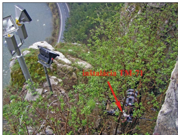
Obr. 21. Pozícia dilatometra TM-71 v trhline pod kaplnkou hradu Strečno.
