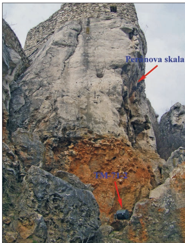
Obr. 14. Inštalácia dilatometra TM-71-2 v trhline pod Perúnovou skalou (vchod do Podhradskej jaskyne).
