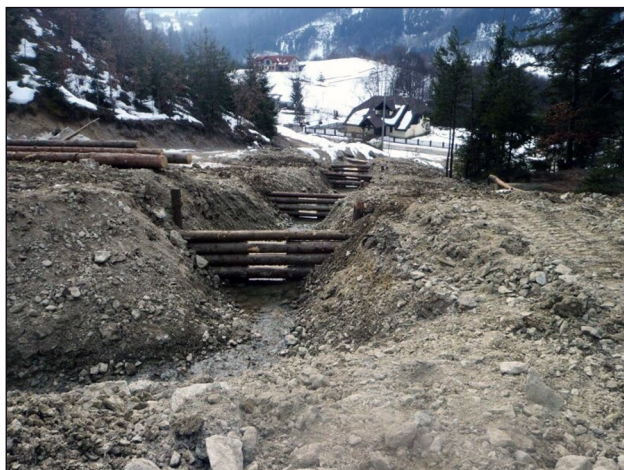
Obr. 19. Masívnou eróziou, spôsobenou prívalovými dažďami v roku 2010, zdevastovaná spodná časť údolia Zelenej doliny nad retenčnou nádržou (voda vyhlbila v sedimentoch miestami až 2 m hlbokú strž).
