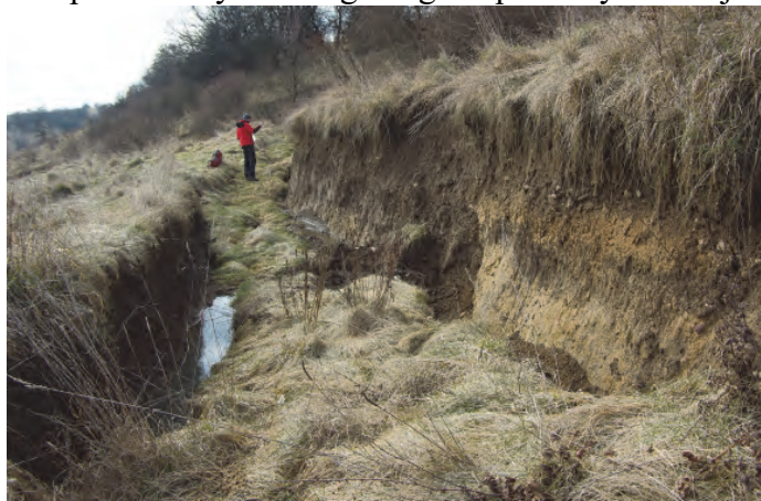
Dolná Mičiná - Odlučná oblasť zosuvu z prístupovej cesty
