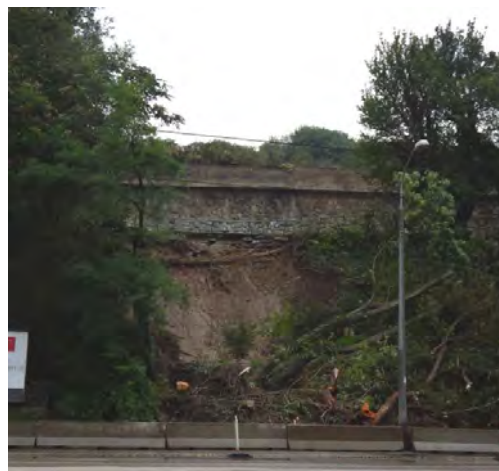
Bratislava – PKO Odľučná hrana zosuvu, porušujúca miestnu komunikáciu
