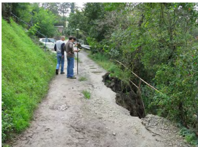
Bratislava – Devínska cesta Odľučná hrana zosuvu, porušujúca miestnu komunikáciu
